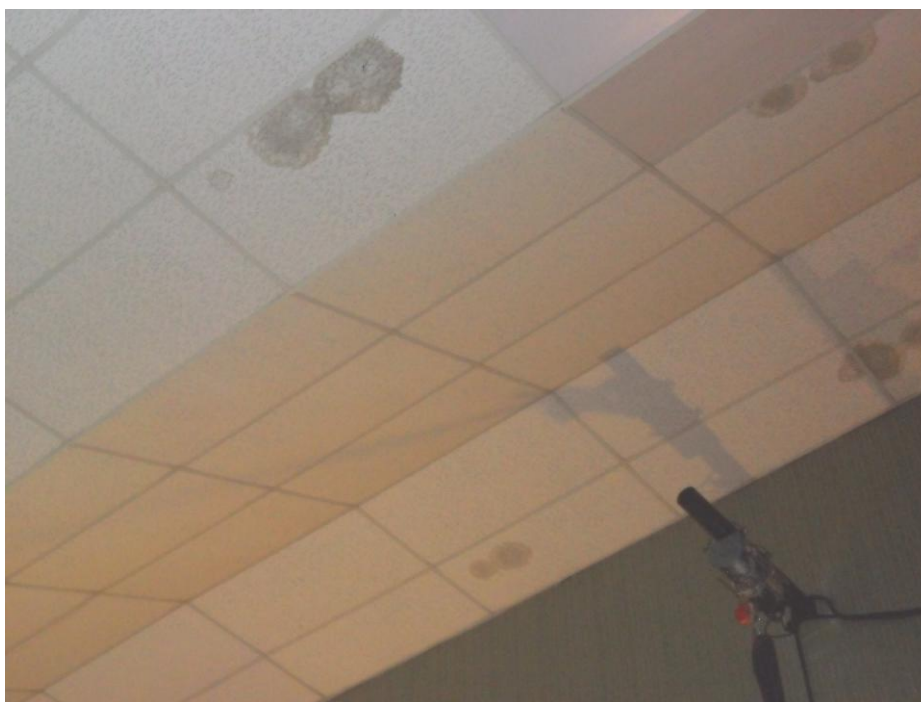
Humedades en el falso techo
